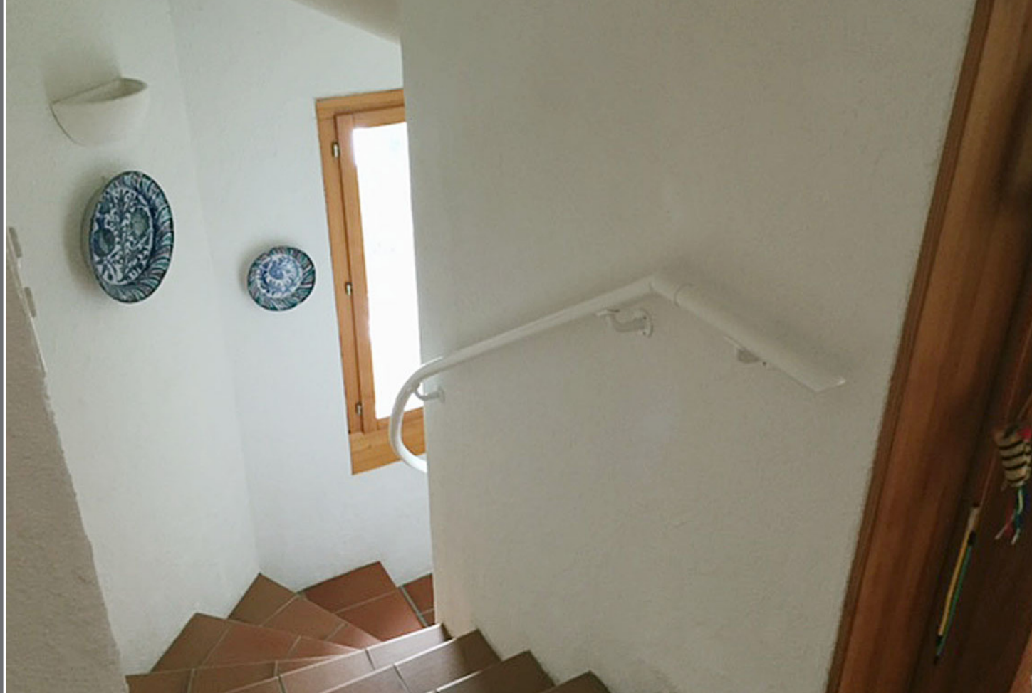
Handlauf innenseitig, da wandseitig ein Fenster ist
