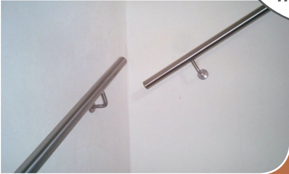
Solche Handläufe sind nicht sicher!
