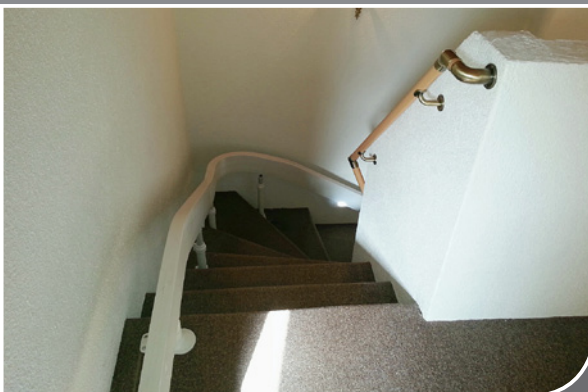
Handlauf innen, weil wandseitig ein Treppenlift montiert wurde
