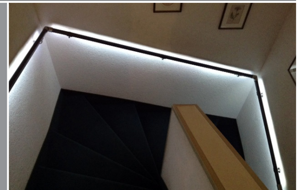
Durchlaufende Beleuchtung mit 35 mm starkem Handlauf
