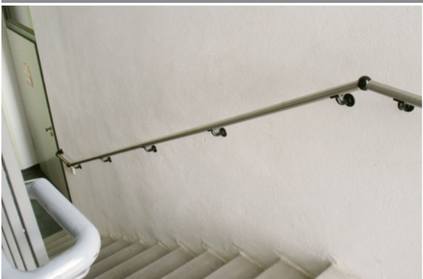
Bürogebäude: nachgerüstet mit wandseitigem Handlauf
