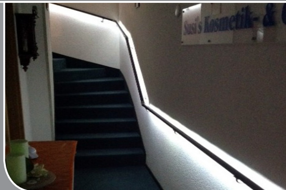
Ausleuchtung an Flur und Treppe
