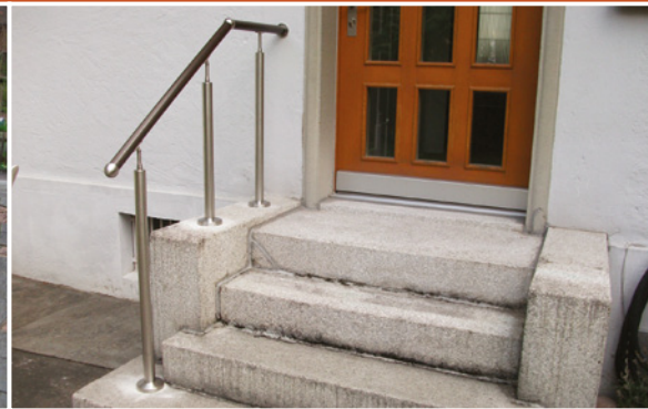
Handlauf mit aufgeschraubten Stützen vor der Haustüre
